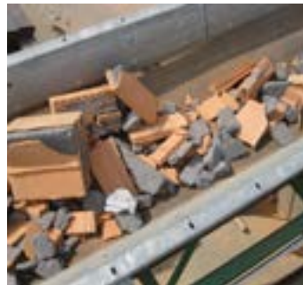
Der Ziegelbruch gelangt über ein Förderband zum Backenbrecher und anschließend zum Wasserbad.
